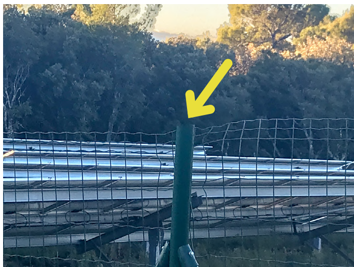
ill. 94. Sur cette CPV, un seul poteau n'était pas capoté car il avait été recoupé après la pose.
