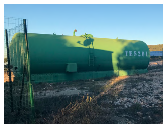
ill. 75. Cuve incendie implantée hors clôture.
