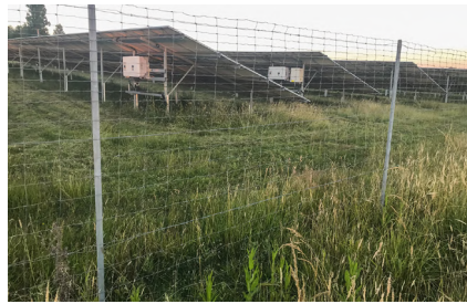
ill. 106. Exemple autour d'une CPV d'une clôture souple à mailles progressives posée de façon inversée en positionnant les grandes mailles au niveau du sol. (photo : C. Buton)
