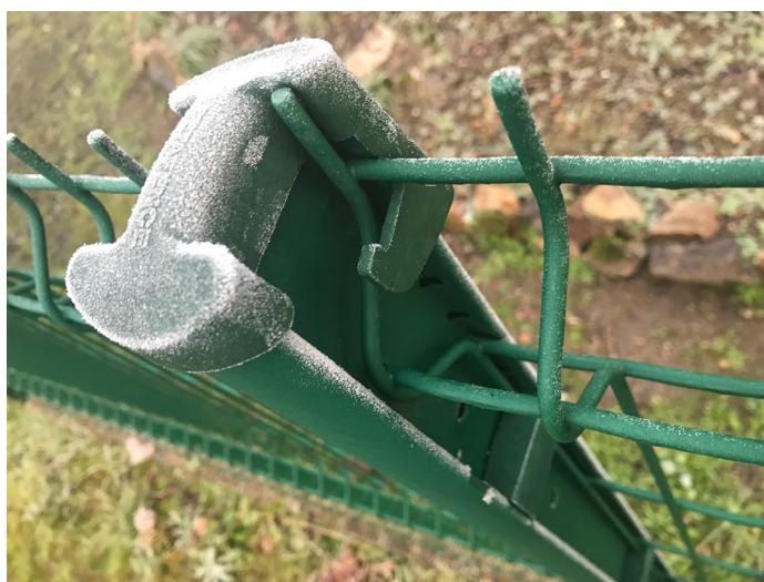
ill. 96. De nombreux systèmes de capots existent selon les poteaux : ici un crochet le bloque au grillage rigide.
