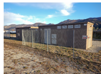
ill. 74. Locaux techniques inclus ou non dans la clôture. Le point de livraison (PDL - à gauche) est en limite de clôture. Le poste de transformation (PDT - à droite) est dans la clôture.
