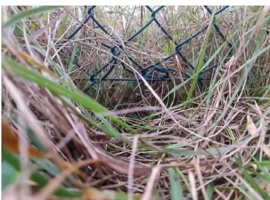
ill. 108. Coulée sous un grillage simple torsion. Ici, les picots ont été relevés pour ne pas causer de blessures. (photo : © LUXEL)
