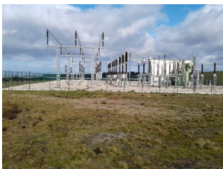
ill. 69. Poste HTB clôturé. (photo : © OFB)
