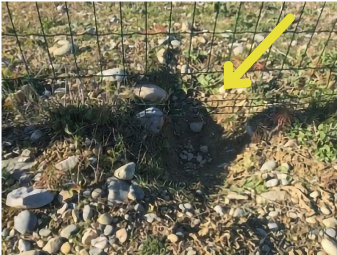
ill. 45. Traces de passages sous une clôture de CPV. Ici, des animaux creusent et passent sous la clôture plutôt qu'à travers les mailles endommagées par le fauchage (flèche jaune). (photo : C. Buton)
