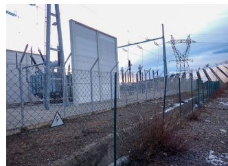
ill. 70. Double clôture au droit d'un poste HTB. A l'intérieur d'une clôture d'exclusion générale en grillage souple simple torsion, le poste est sécurisé par un grillage semi-rigide rehaussé par un bavolet à 3 rangs de barbelés et monté sur des plaques de soubassement en béton.
