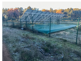
ill. 71. Réserve d'eau en bache souple incluse dans la clôture périmétrale d'une CPV.
